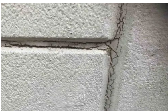
シーリング材の劣化（割れ）
