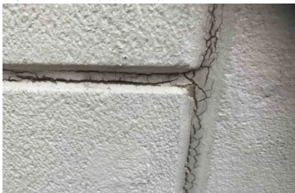
シーリング材の劣化（割れ）
